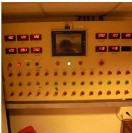
控制室懸吊系統控制面板
