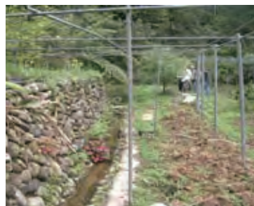
▲內湖某農地申請農地水土保持輔導（左圖），經水土保持服務團指導後，完成駁坎補強、水溝拓寬，並於末端增設水塘（右圖），不但坡地安全獲得保障，景觀也美化了
